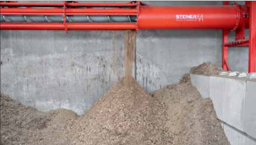
Eine Förderschnecke von Steiner verteilt die Hackschnitzel im Bunker.
