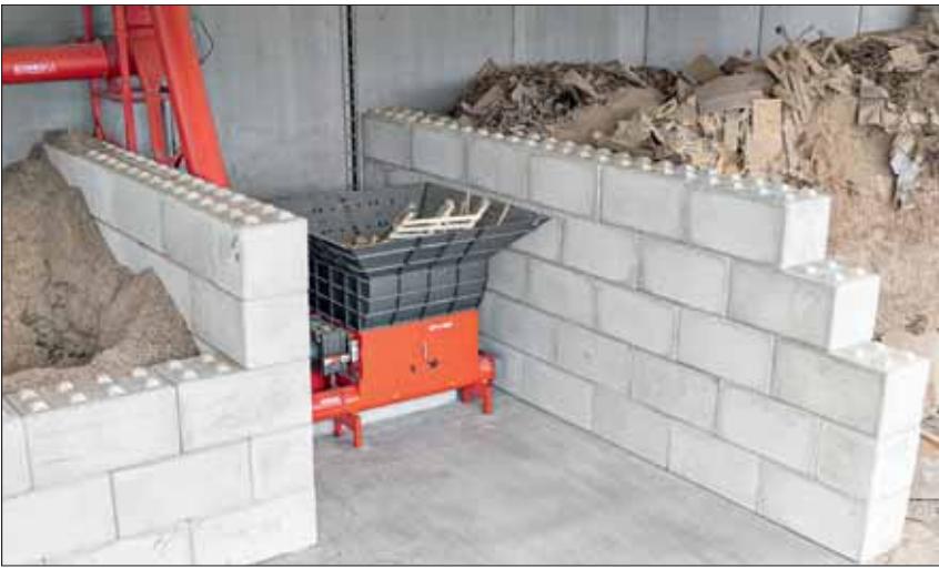
Der Zerkleinerer befindet sich zwischen dem Bunker für das Restholz und dem für die erzeugten Hackschnitzel.
