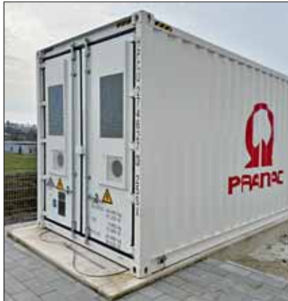
Ende vergangenen Jahres wurde als Ergänzung zur PV-Anlage ein großer Batteriespeicher installiert.
